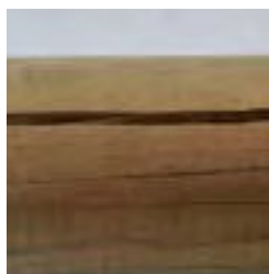
Cracks/Grietas/Fente/Risse/ Crepe/ Barsten/Fendas
